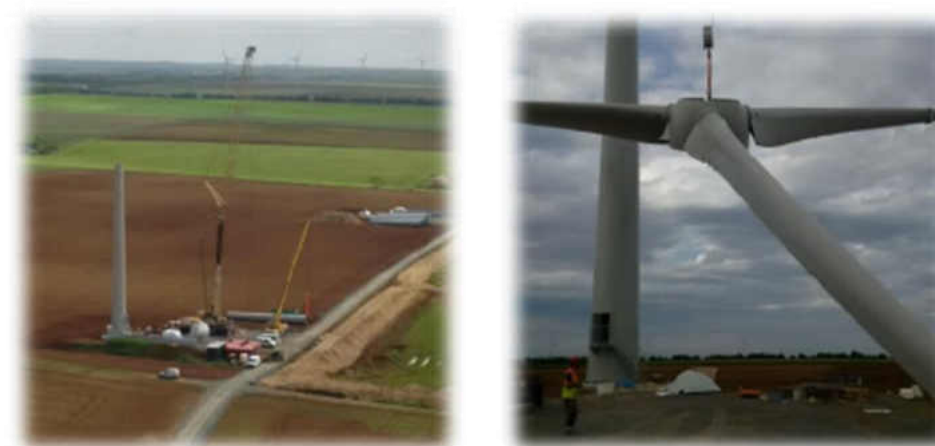
Figure 17 : Montage du mât (à droite) et levage du rotor (à gauche) (Source : ENERCON)
